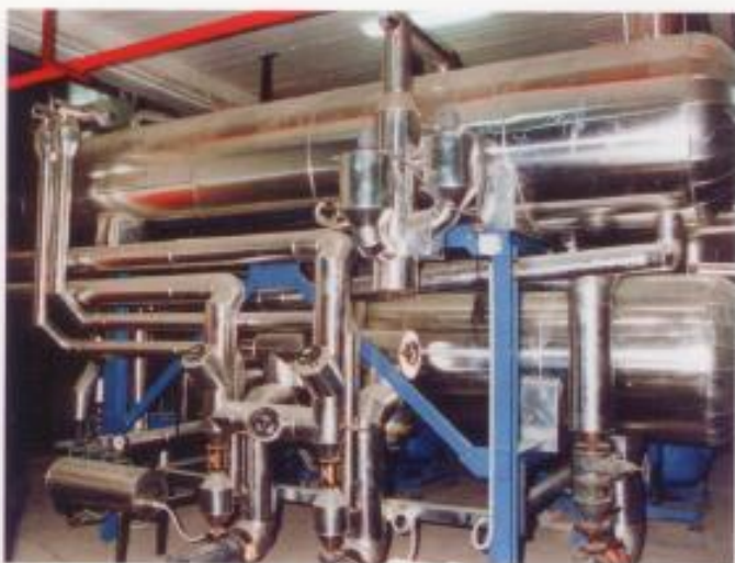
Ψυκτικές μονώσεις δεξαμενών και αγωγών αμμωνίας HELLENIC CATERING
